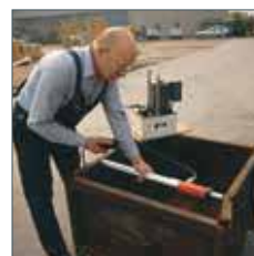
Richtarbeiten mit Hydraulikzylinder YS-10/100, Verlängerungsrohr AYS-106, Bodenadapter AYS-103 und Elektropumpe PY-04/2/5/2 M.
